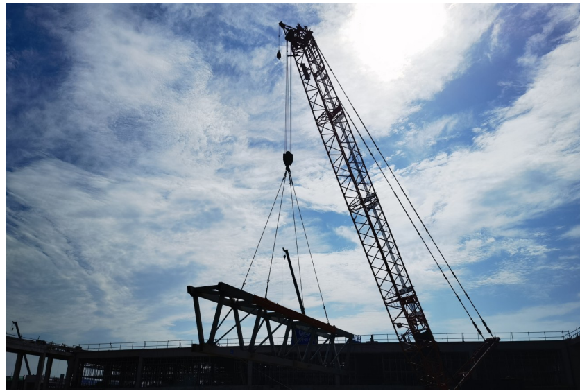
7月22日,郑州航空港中原国际会展中心项目11号展厅首樑主桁架顺利安装完毕,标志着项目全面进入屋盖管桁架钢结构安装阶段。(郑州航空港地区指挥部 刘智强 摄影报道)
