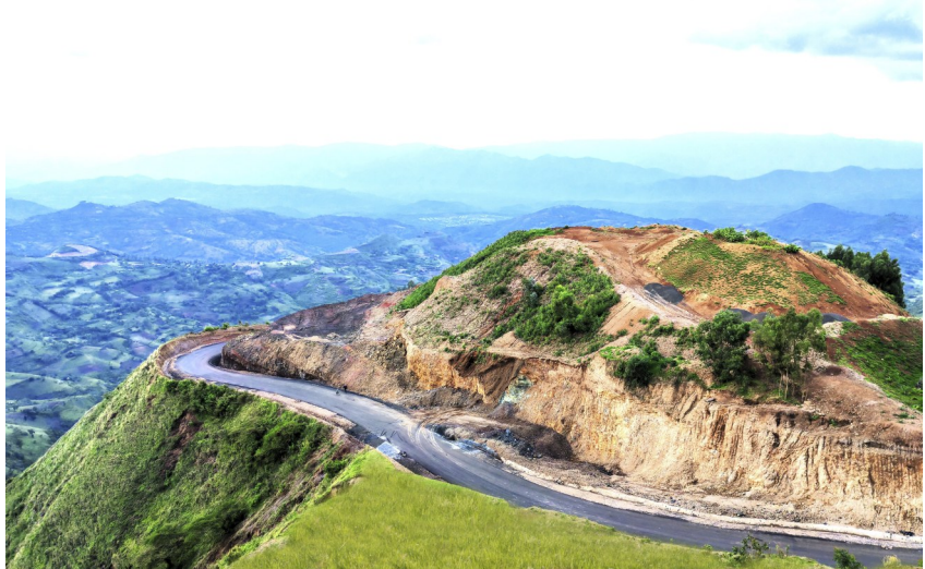
当地时间4月13日,中铁七局埃塞俄比亚地区83.4公里项目沥青施工摊铺完毕,标志着该项目主线顺利贯通。该公路位于埃塞俄比亚西南州Dawru区,全长83.4公里,双向两车道,是连接西南州重要城市SODO市与JIMA市的唯一一条主干道。项目所在地属于丘山区,道路陡峭,全线海拔从685米到2450米,高差最大处近1800米,特别是改线段Turi-Waka段9.5公里,道路纵坡几乎全部接近山区道路极限纵坡12%,施工难度大。(海外公司 李根 严旺亭 陈葭)
