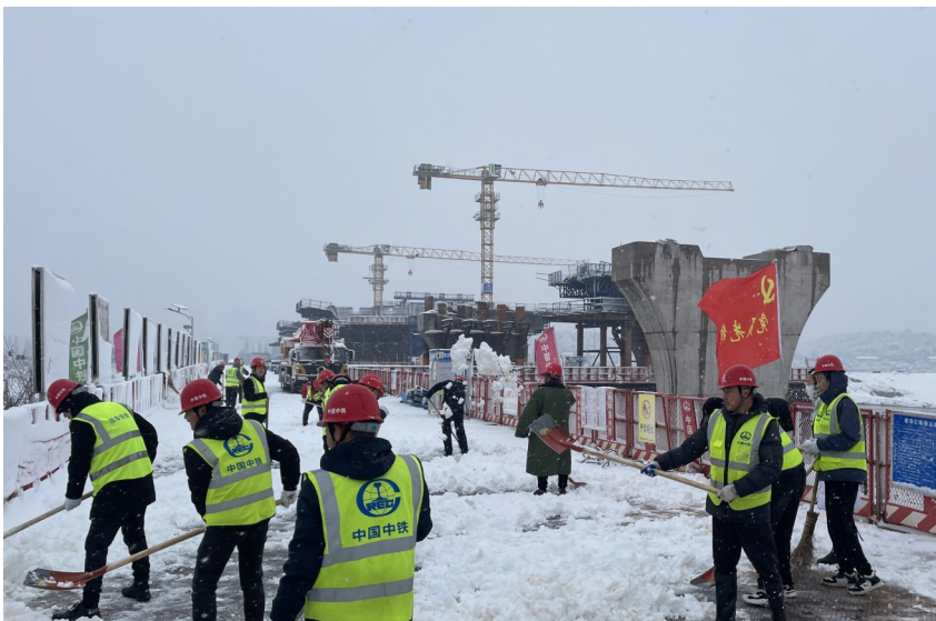
近日,湖南省遭受了全省性的暴雪袭击,为保障项目正常施工和附近居民出行安全,1月22日,三公司长沙金安大道项目党支部组织全体党员积极开展“党员先锋在行动,扫雪除冰保施工”主题党日活动,以实际行动保障项目的正常施工和群众出行方便。(三公司 郑平安 摄影报道)
