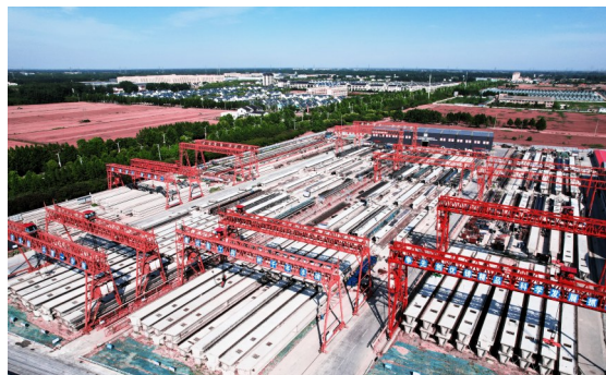
10月14日,三公司滨淮高速项目预制梁场完成所有预制梁生产任务。该制梁场位于江苏省盐城市滨海县医药产业园内,占地面积100亩,主要负责5340片预应力混凝土箱梁预制及滨淮高速1标至6标的运梁任务。(三公司 樊永强)
