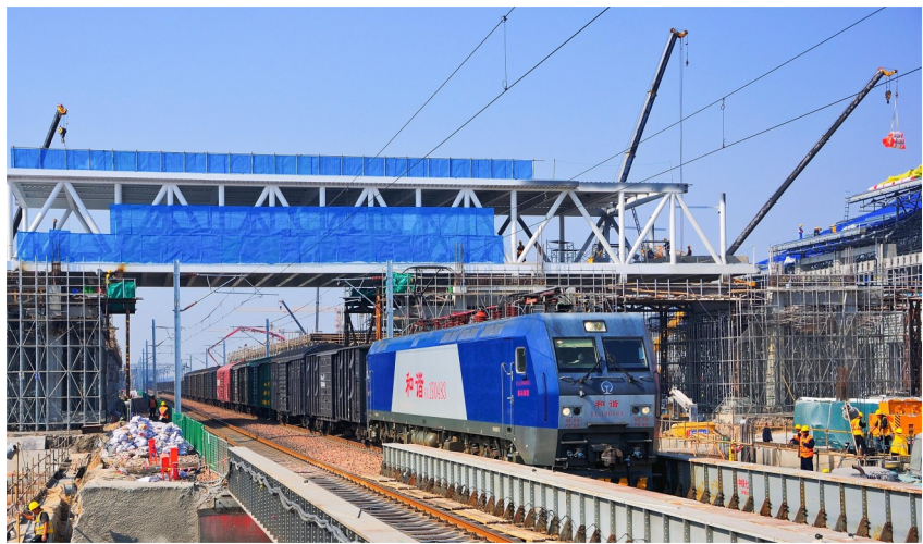
10月24日,郑开城际铁路延长线项目新建开封站跨铁路旅客天桥安全顶推到位,为恢复办理开封站客运业务提供了有力保障。此次顶推的跨铁路旅客天桥,长48.5米,总重200吨,顶进总长度30.6米。(郑州公司 郭武军 郑开城际项目部 蔡百顺)
