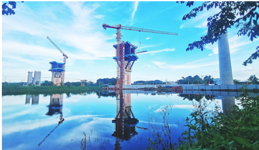
7月30日,郑州公司珠肇高铁全线首个跨省道连续梁——跨广明高速特大桥跨S297连续梁0号块准备进行浇筑施工。该特大桥全长2631.47米,跨S297连续梁全长245.8米,是项目重难点控制性工程。此次浇筑的0号块设计方量506立方米,预计8月3日浇筑完成。(郑州公司 翟刚 摄影报道)
