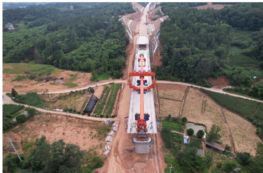
近日,由长江沿岸铁路集团建设管理、中铁七局承建的沪渝蓉高铁武宜段7标项目香烟寺隧道、金塔2号隧道两座隧道齐头并进,实现同日贯通,刷新了项目单日隧道贯通记录,为项目建设按下快进键。(武汉公司 王建勋 摄影报道)
